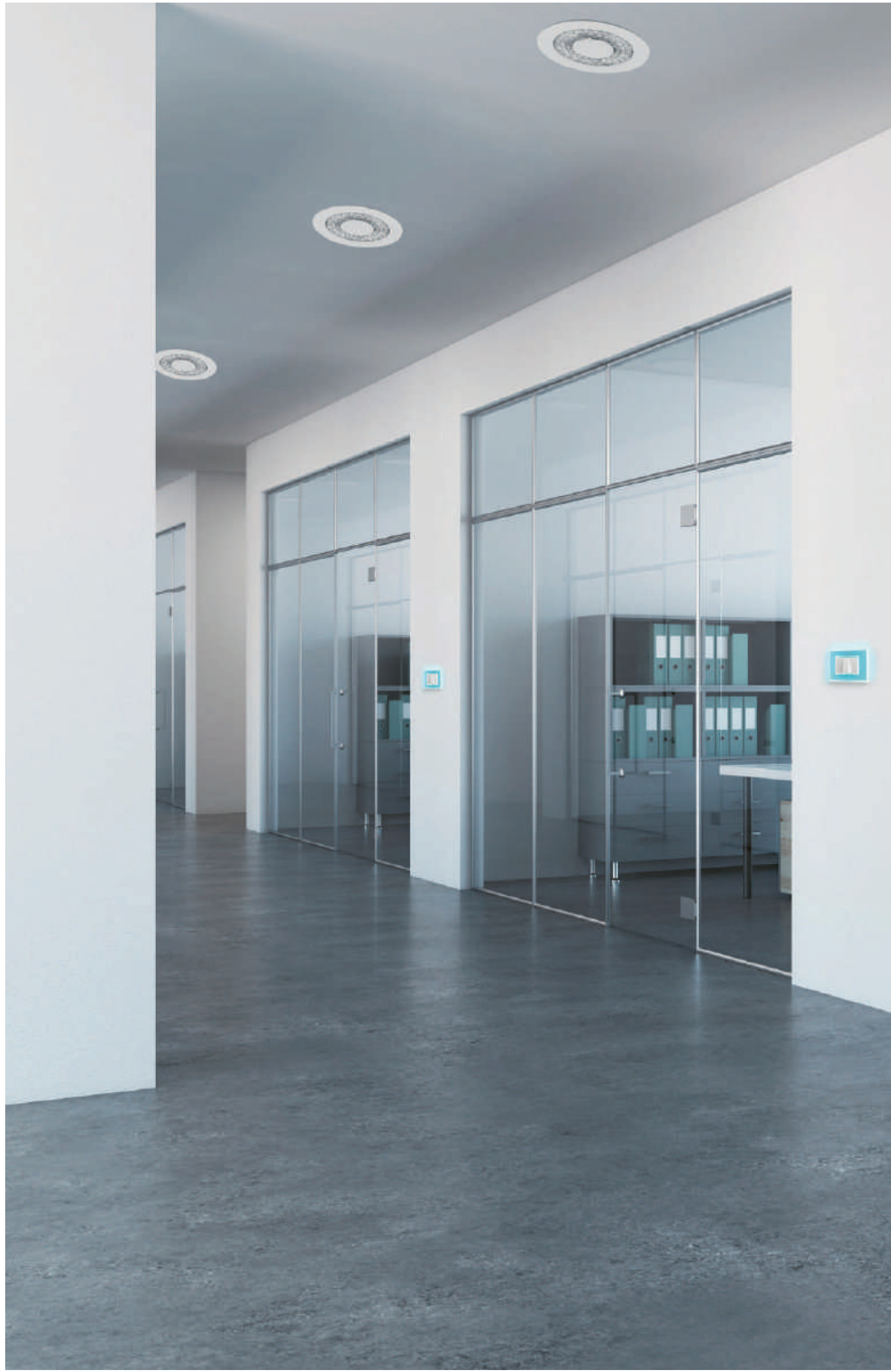
055 oprawy typu downlight
