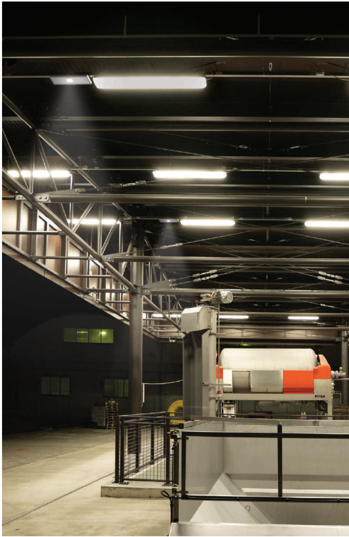
047 oprawy oświetlenia awaryjnego
