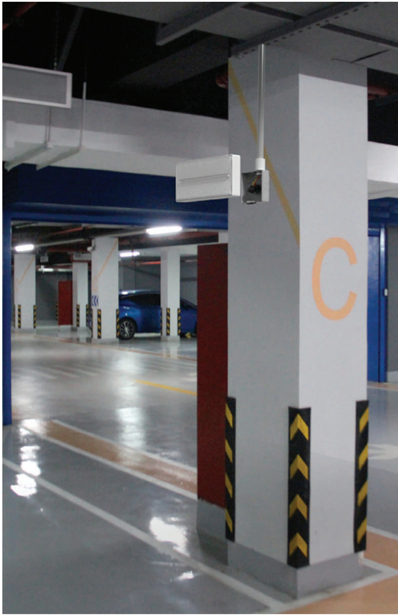
035 oprawy oświetlenia awaryjnego
