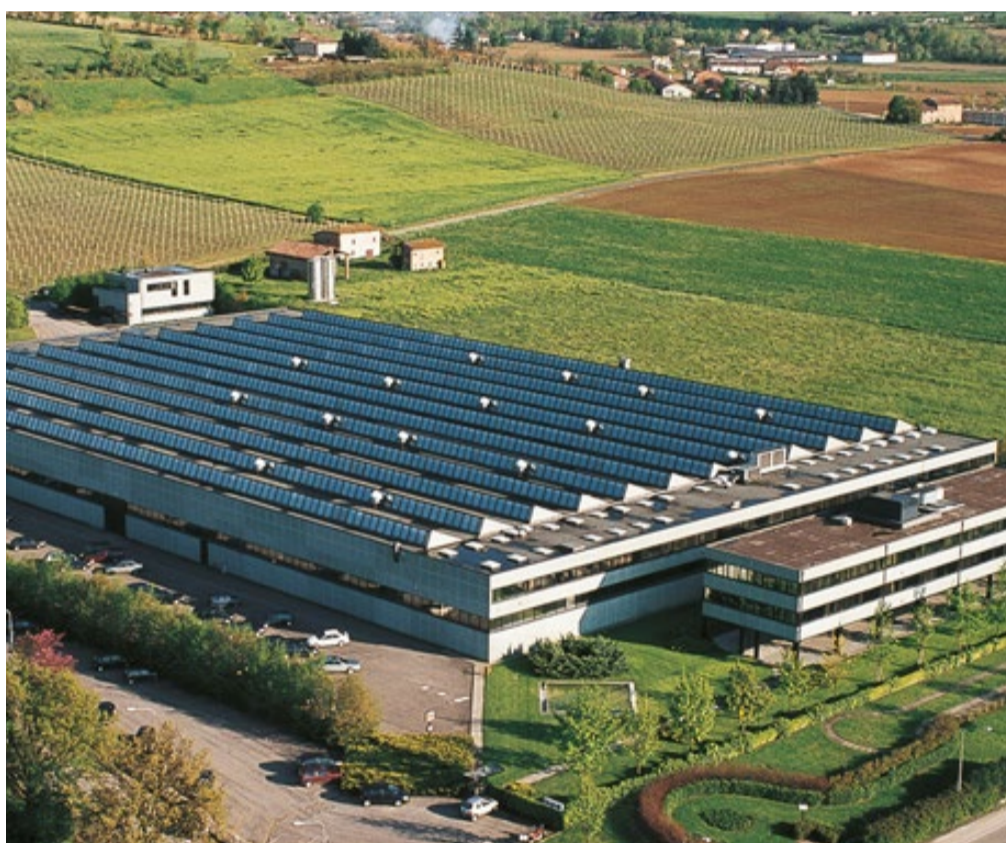
Montevoglio (BO) - impianto fotovoltaico di 474.788Wp
