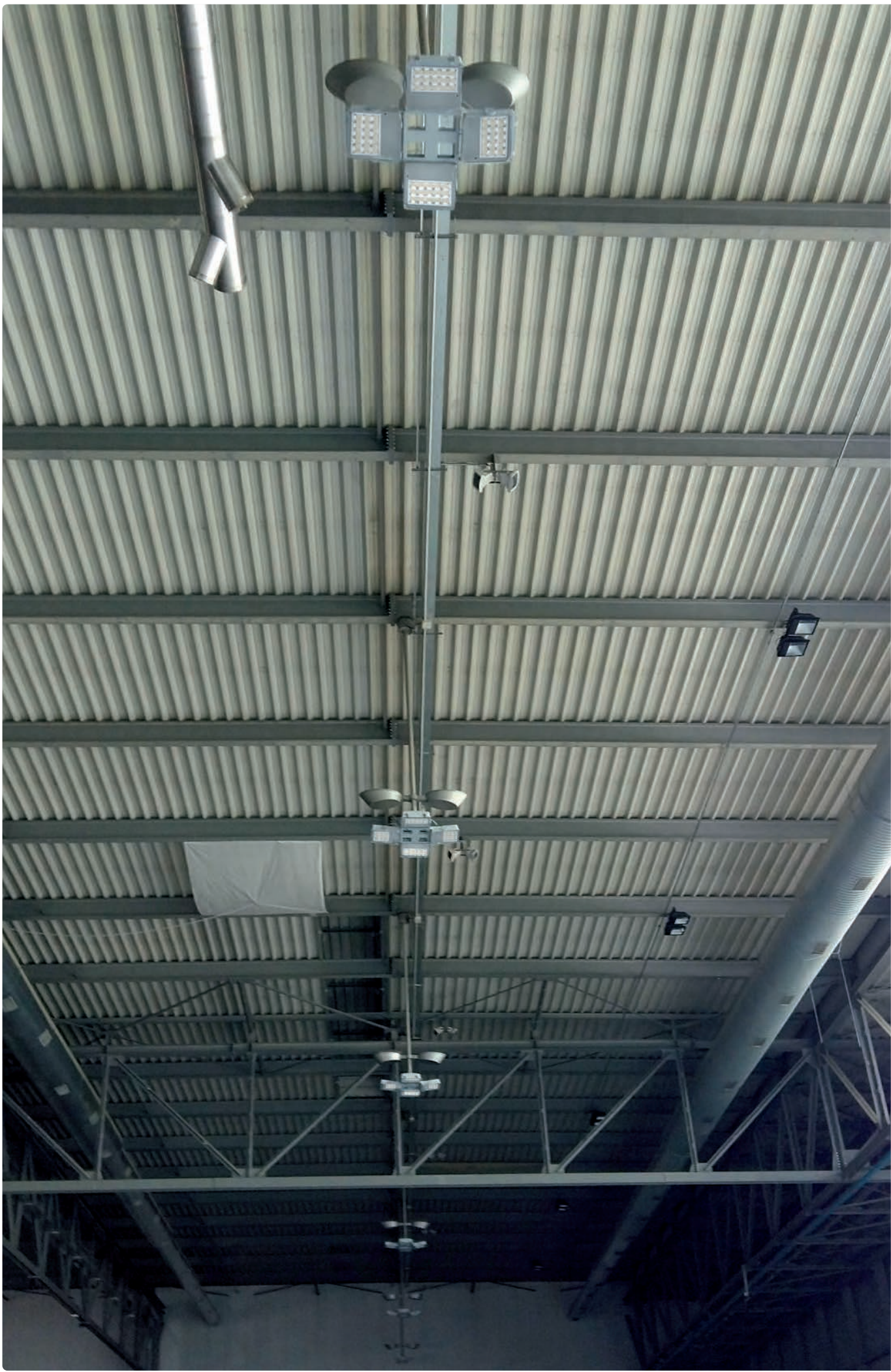
127 proiettori da esterno / outdoor floodlights
