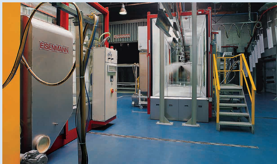
Automatizovaná lakovací linka Eisenmann Eisenmann automated painting line Автоматизированная лакировочная линия Eisenmann
